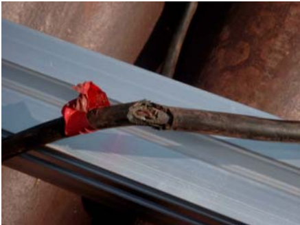
Foto Kabelschaden durch Marderverbiss
